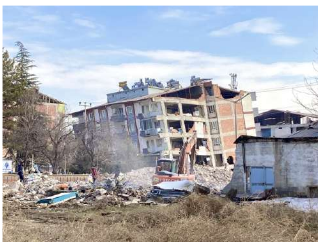
エルビスタン市内で大被害を受けた建物（2023年2月）
